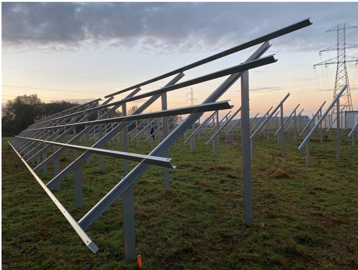
Zdjęcie 7 Konstrukcja wsporcza na farmie PV
