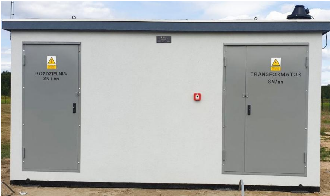
Zdjęcie 3 Przykładowa stacja transformatorowa
