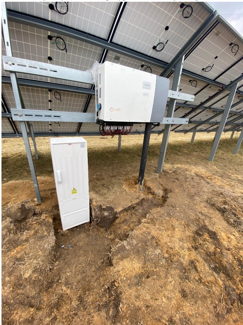
Zdjęcie 4 Przykładowy montaż inwerterea
