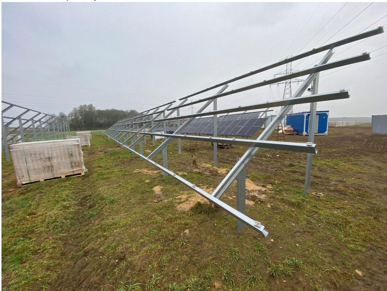
Zdjęcie 2 Przykładowa konstrukcja wsporcza
