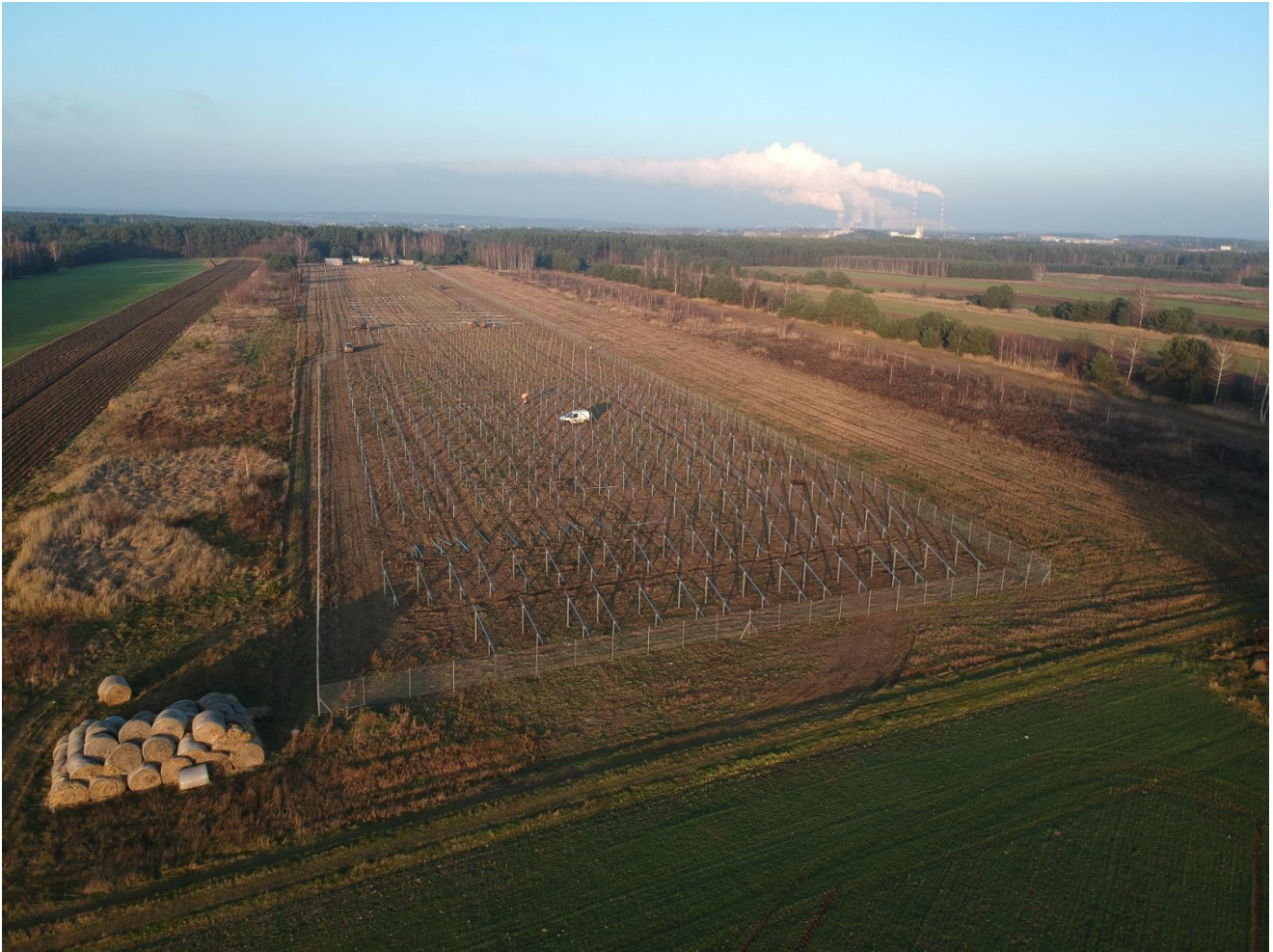
Zdjęcie 8 Konstrukcja wsporcza na farmie fotowoltaicznej - widok z góry
