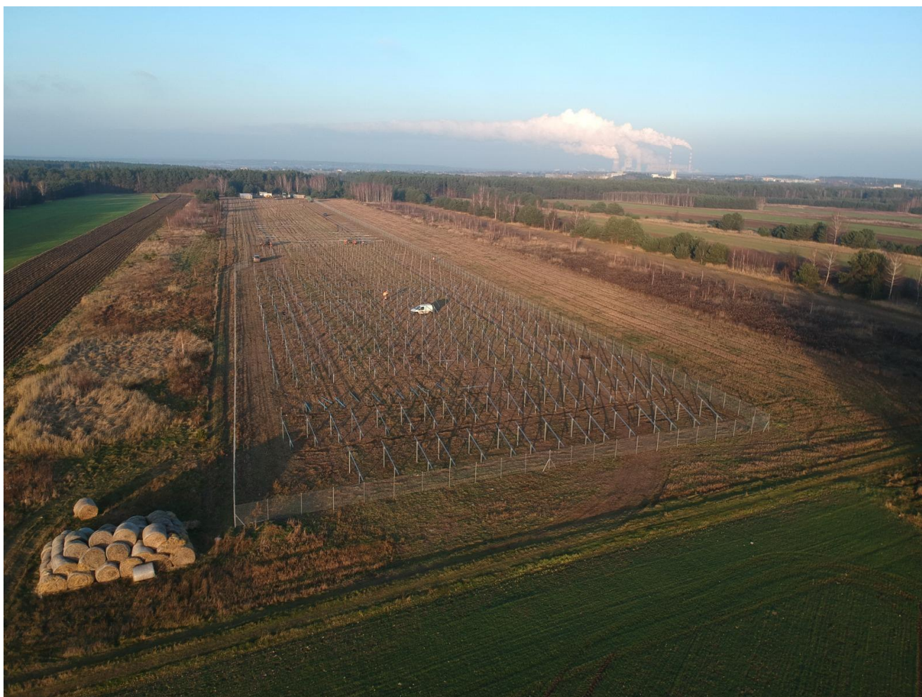
Zdjęcie 7 Konstrukcja wsporcza na farmie fotowoltaicznej - widok z góry
