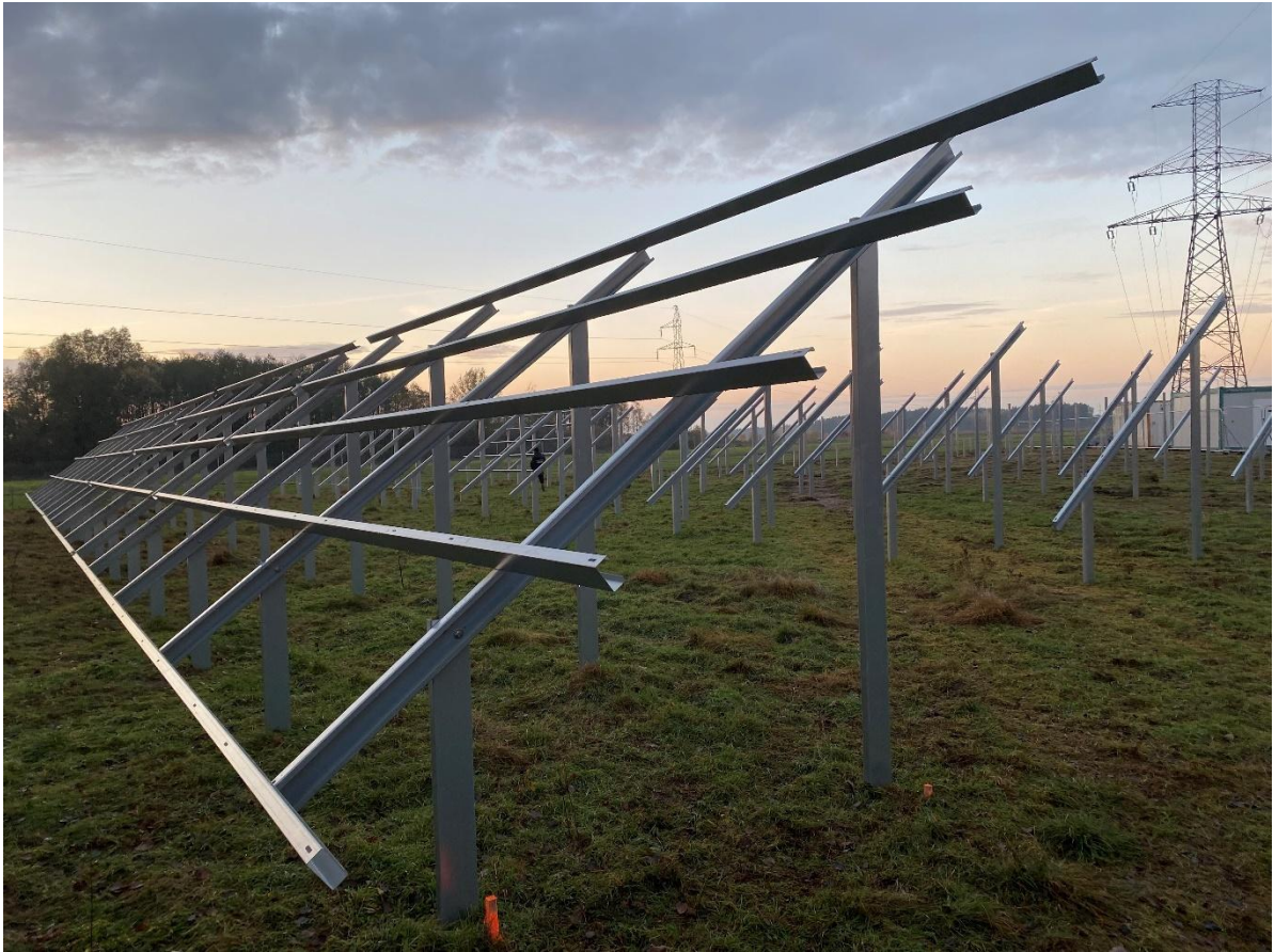
Zdjęcie 6 Konstrukcja wsporcza na farmie PV
