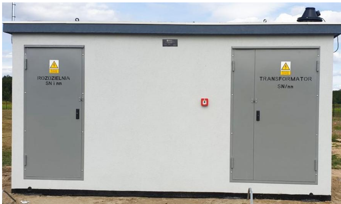
Zdjęcie 2 Przykładowa stacja transformatorowa
